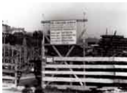
Cartello di inizio lavori della costruzione della nuova sede della Scuola negli anni Settanta.
