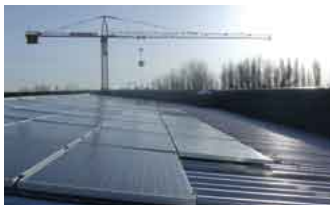
Nel 2008 la Scuola si è dotata di un sistema di pannelli fotovoltaici.
